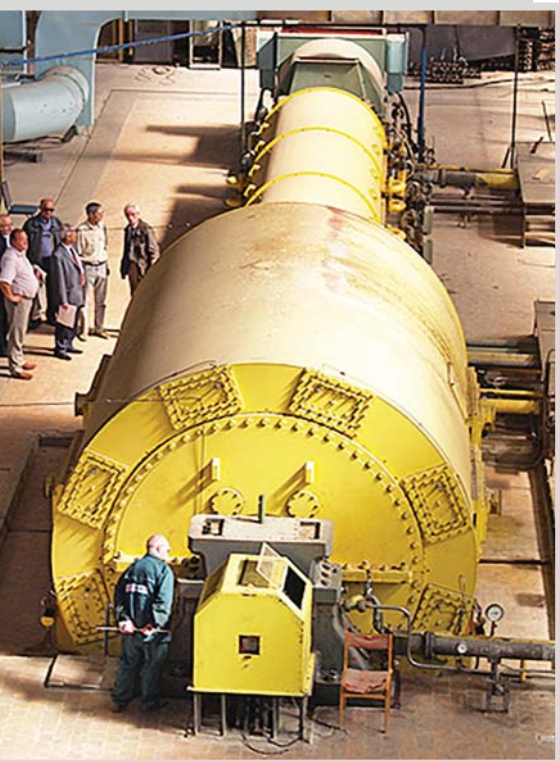
Электромашинный агрегат энергокомплекса ТСП
